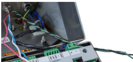
Figure A-52 : Câbles de mise à la masse et câble de masse interne torsadés ensemble
